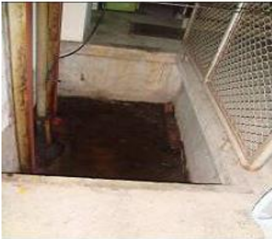
地下室之升降梯孔積水
