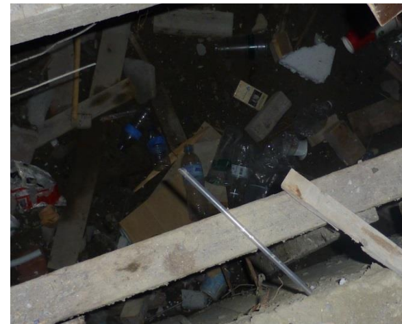
建築工地廢棄物堆積處
