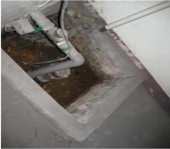
地下室儲水槽
